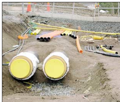
En typisk ledningsgrav med fjärrkyla DN500 i botten. Övan från vänster Birkas kanalisering för signal- och optokabel, kanalisering för telecom och till höger Birkas Nätets högspänningskablage.
