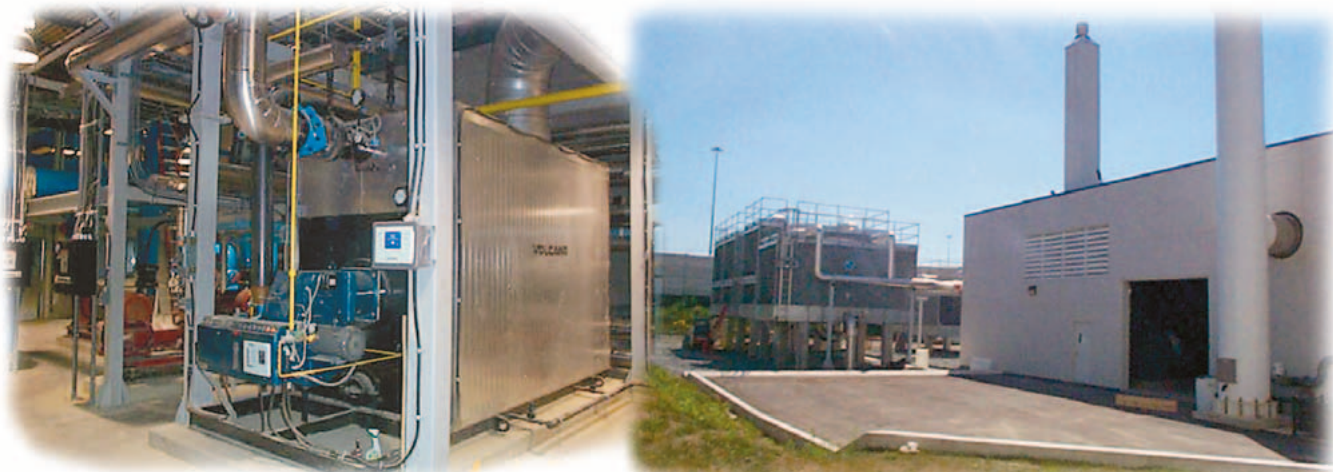
De två gaseldade pannorna till fjärrvärmesystemet i Markham.
